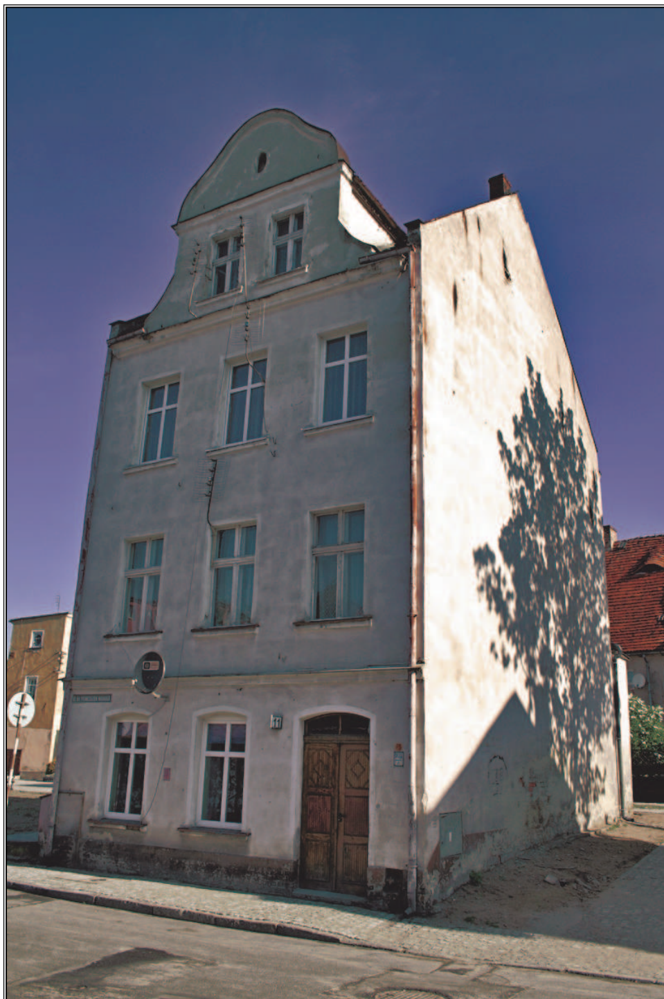
Fot. 10. Budynek przy ulicy Bosaka 11. Widoczna zniszczona elewacja budynku negatywnie wpływa na estetykę otoczenia.
