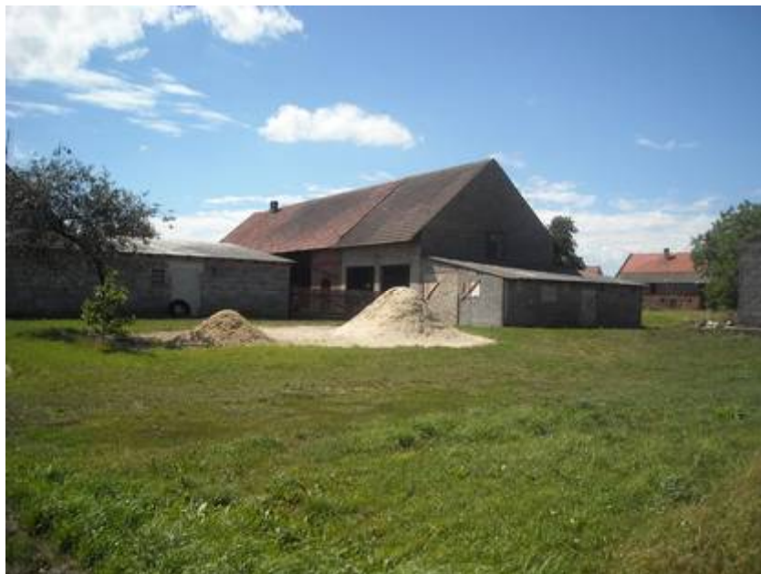
Fot. 6. Dachy, w tym zadaszenia azbestowe, o różnych spadkach. Budynek mieszkalny 45° i sąsiednie budynki gospodarcze 15°.
