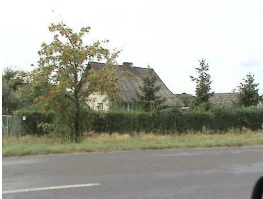
Fot. 2. Budynek mieszkalny pokryty płytami azbestowymi – Lipnica nr 39.
