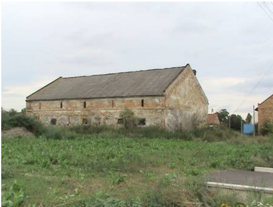
Fot. 1. Budynek gospodarczy w złym stanie technicznym pokryty uszkodzonymi płytami azbestowymi w miejscowości Łososiowice.
