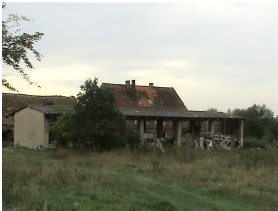
Fot. 3. Wiata na słupach pokryta płytami azbestowymi (Lubiąż, ul. Św. Jadwigi).
